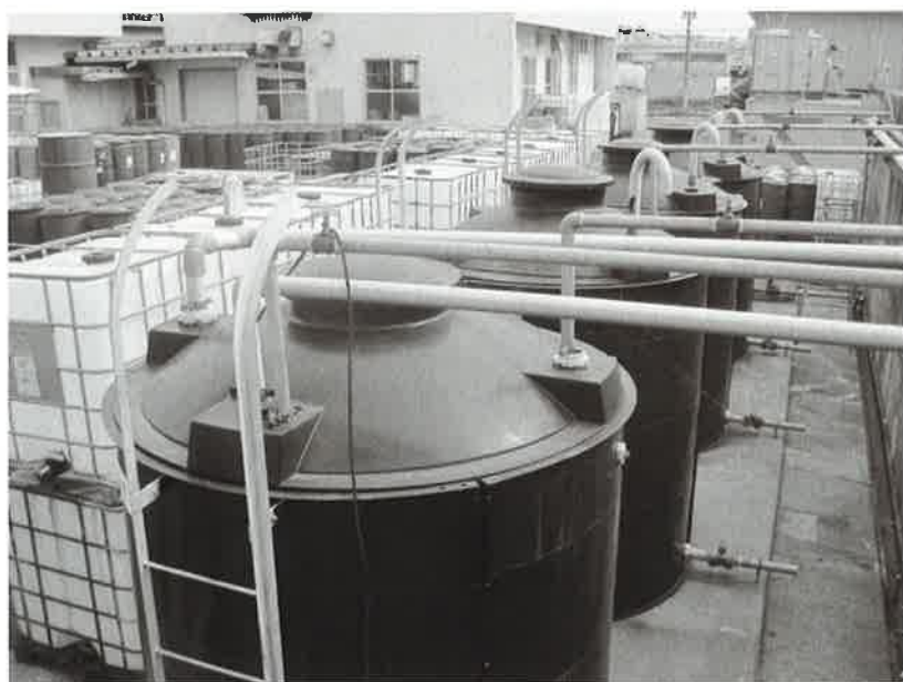
自社で開発・製造した汚水処理用の曝気槽（浄化槽）
